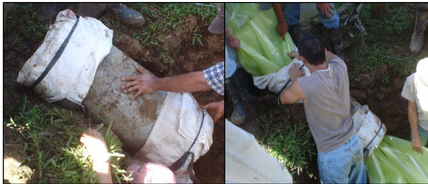
Figura 7. Tuberías de concreto
