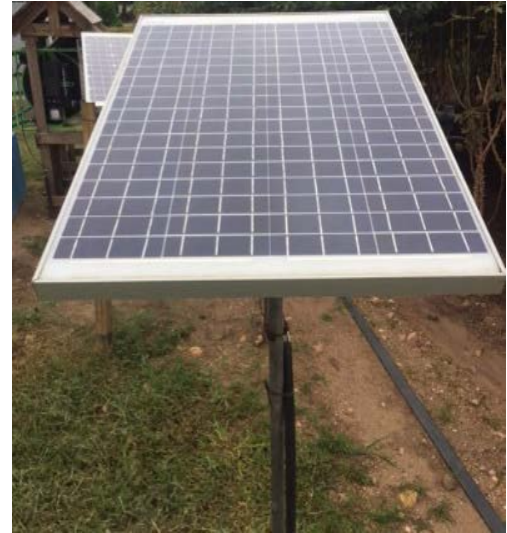
Figura 9. Panel solar 80 W conectado a la bomba sunflower.
