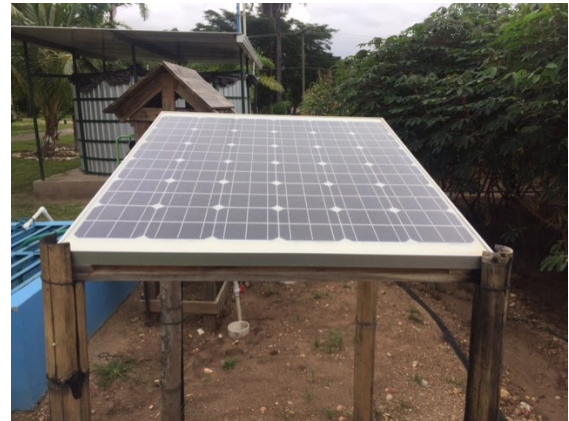
Figura 11. Panel solar 150 W conectado a la bomba sunlight.
