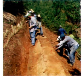
Foto 21. Acequias a nivel.
