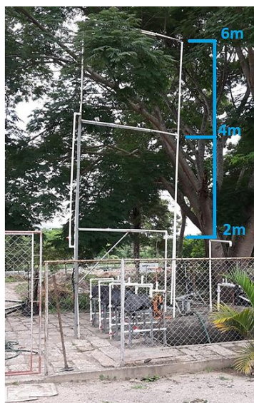
Figura 2. Alturas de descarga de agua dos, cuatro y seis metros en el Centro Productivo para la Innovación Rural Sostenible (CEPiRS) en Zamorano.
