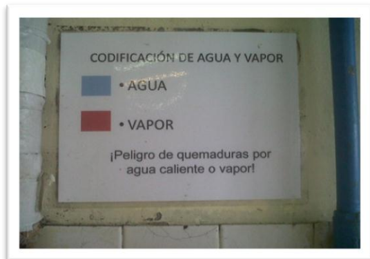
Figura 21: tuberías de conducción de agua fría y vapor
