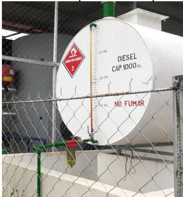
Anexo 2. Tanque de diésel ubicado en la parte trasera de la planta de lácteos.
