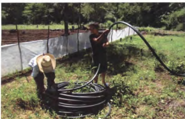
Foto 14. Tubería de polietileno (PE).
